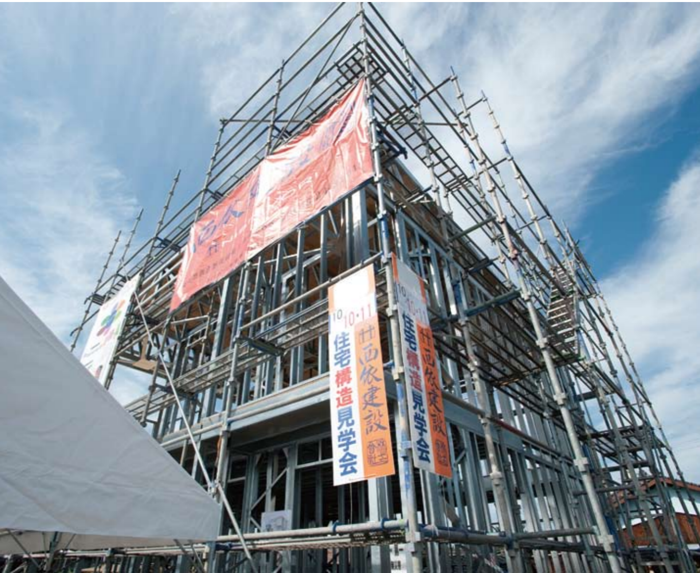
神戸製鋼所が長年培ってきた鉄の表面処理技術による「亜鉛めっき鋼板」を素材にした構造材が、次々と現場で組み立てられていく。この「鉄の骨」が、長年にわたる家族の安心を実現してくれる。また部材の高度な規格化によって、鉄骨の家を手が届く価格で実現したという功績も大きいのではないだろうか（E邸）
